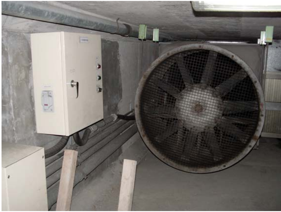
圖十 共同溝強制通風設備
