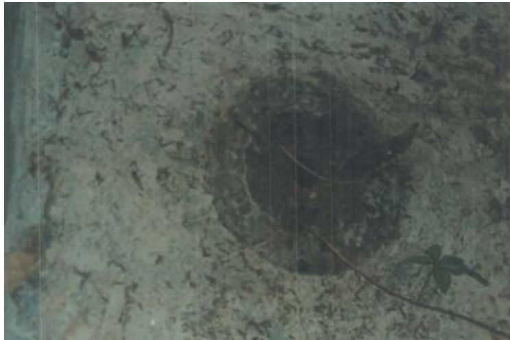
圖四 錨桿（索）腐蝕錨頭剝落
