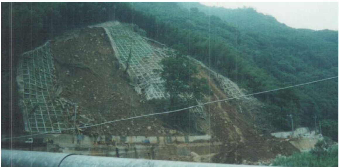
圖五 用於邊坡穩定之錨桿框架結構之破壞
