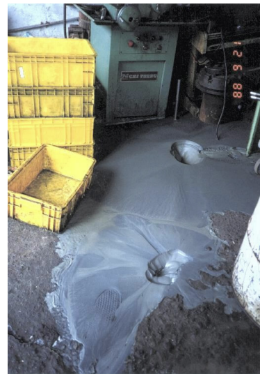
照片2.4 員林液化造成廠房內之噴砂
