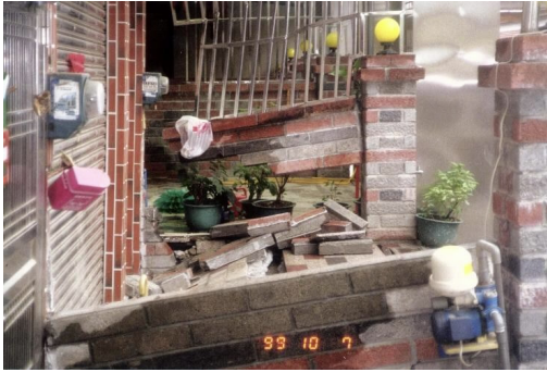
照片2.1 員林液化造成之房屋嚴重下陷
