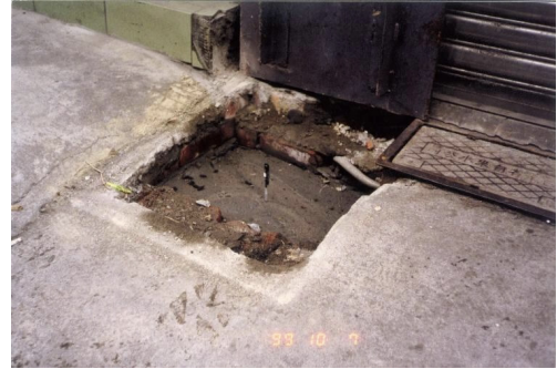
照片2.2 員林液化造成水溝被噴砂塞住
