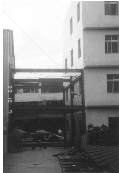
案例7-2 4樓建物與3樓建物均發生傾斜沉陷，目前暫以型鋼加強支撐保護
