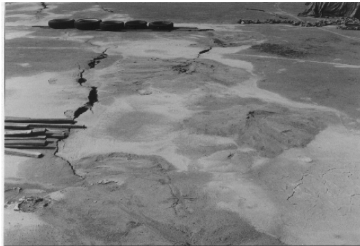
案例9 地坪嚴重龜裂下陷，到處有因噴砂所產生之小砂丘
