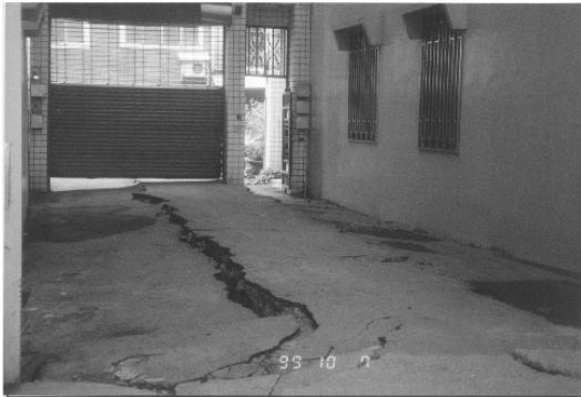
案例8 屋內地坪嚴重隆起破壞，房屋傾斜沉陷約30公分
