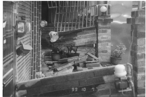
案例7-1 房屋嚴重下陷，造成圍牆及白鐵窗扯壞坍塌
