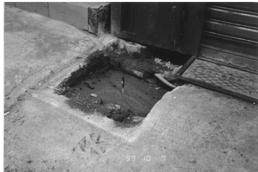
案例2-2 自來水孔中積滿砂，本區之水溝均被噴砂塞滿
