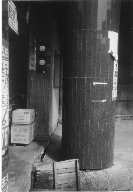
案例4 8樓RC建物傾斜沉陷，地面龜裂沉陷，屋角處有噴砂現象
