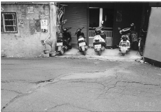
案例5 員集路二段492巷鋪面龜裂下陷，路側房屋傾斜沉陷，裂縫處有噴砂
