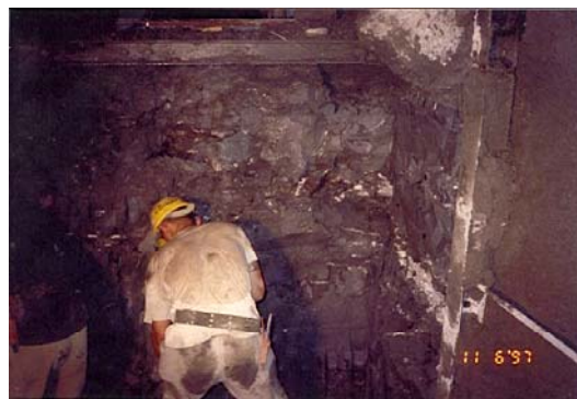
照片十二 北隧道開挖面地改成效(淺色部份為改良體，深色為原狀土)
