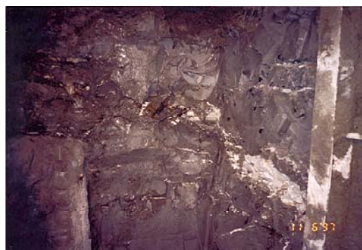
照片十三 北隧道開挖面地改成效(淺色部份為改良體，深色為原狀土)
